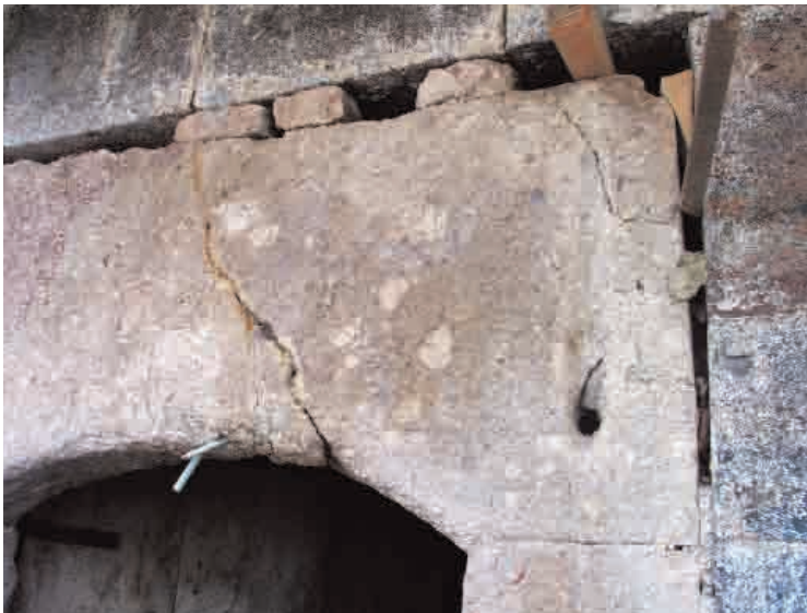
Cracks on minaret door Të çarat në derë e minares
