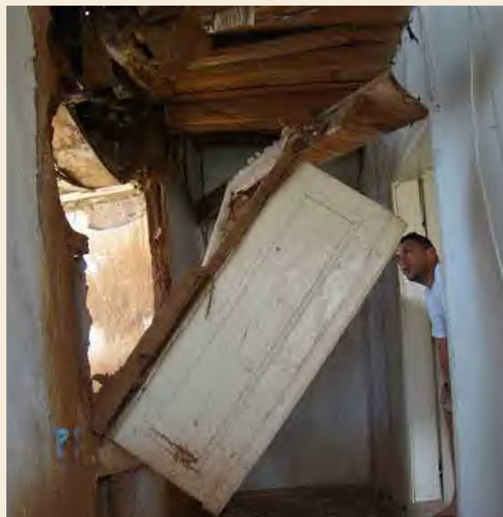
DËMTIMET NË SHITËPI DAMAGES
